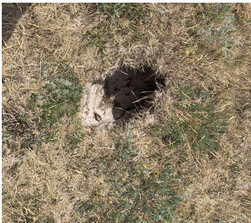
Figur 19 Gravet hul i diget ved st. 2130
